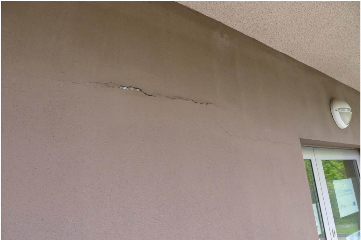
Rysy i spękania na tynku
