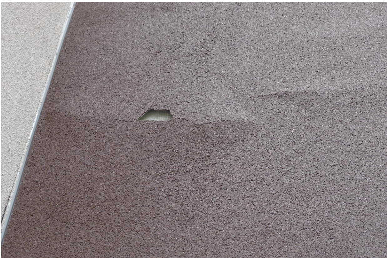
Odspojenia, wybrzuszenia tynku – widoczna siatka zbrojąca
