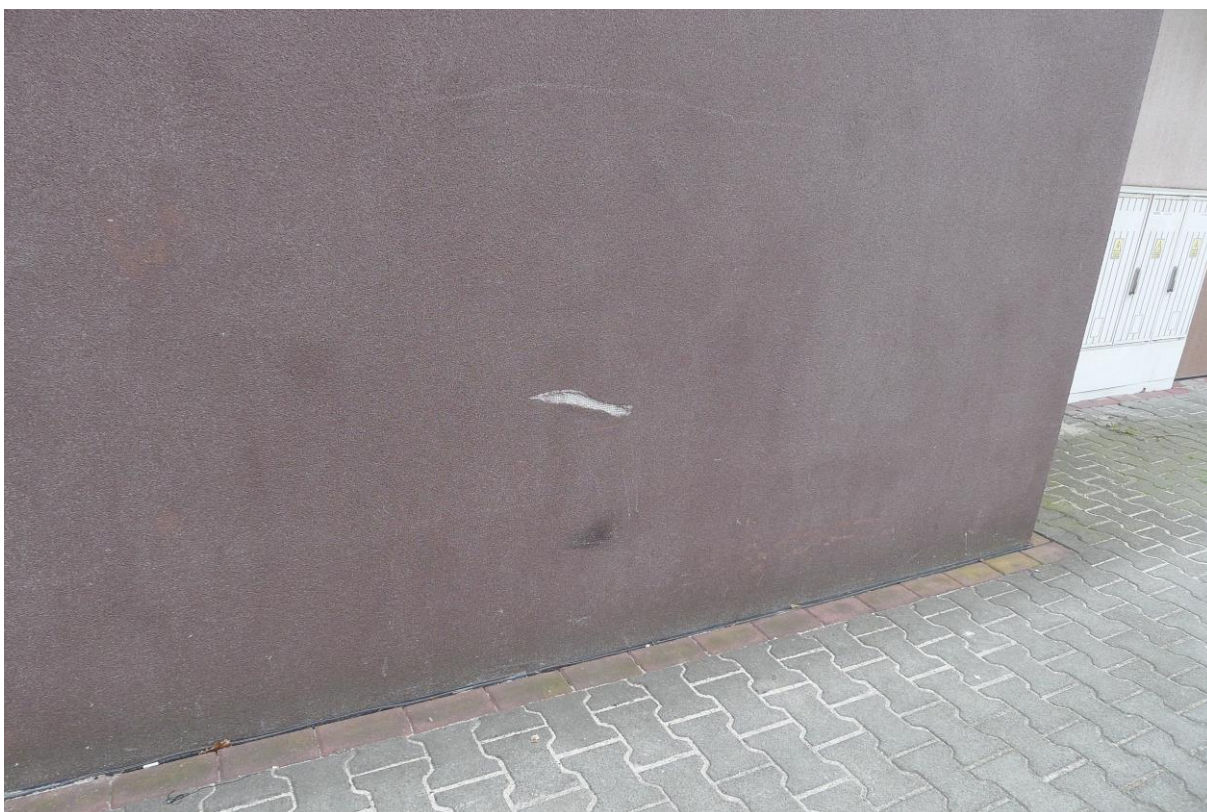
Uszkodzenia mechaniczne na elewacji
