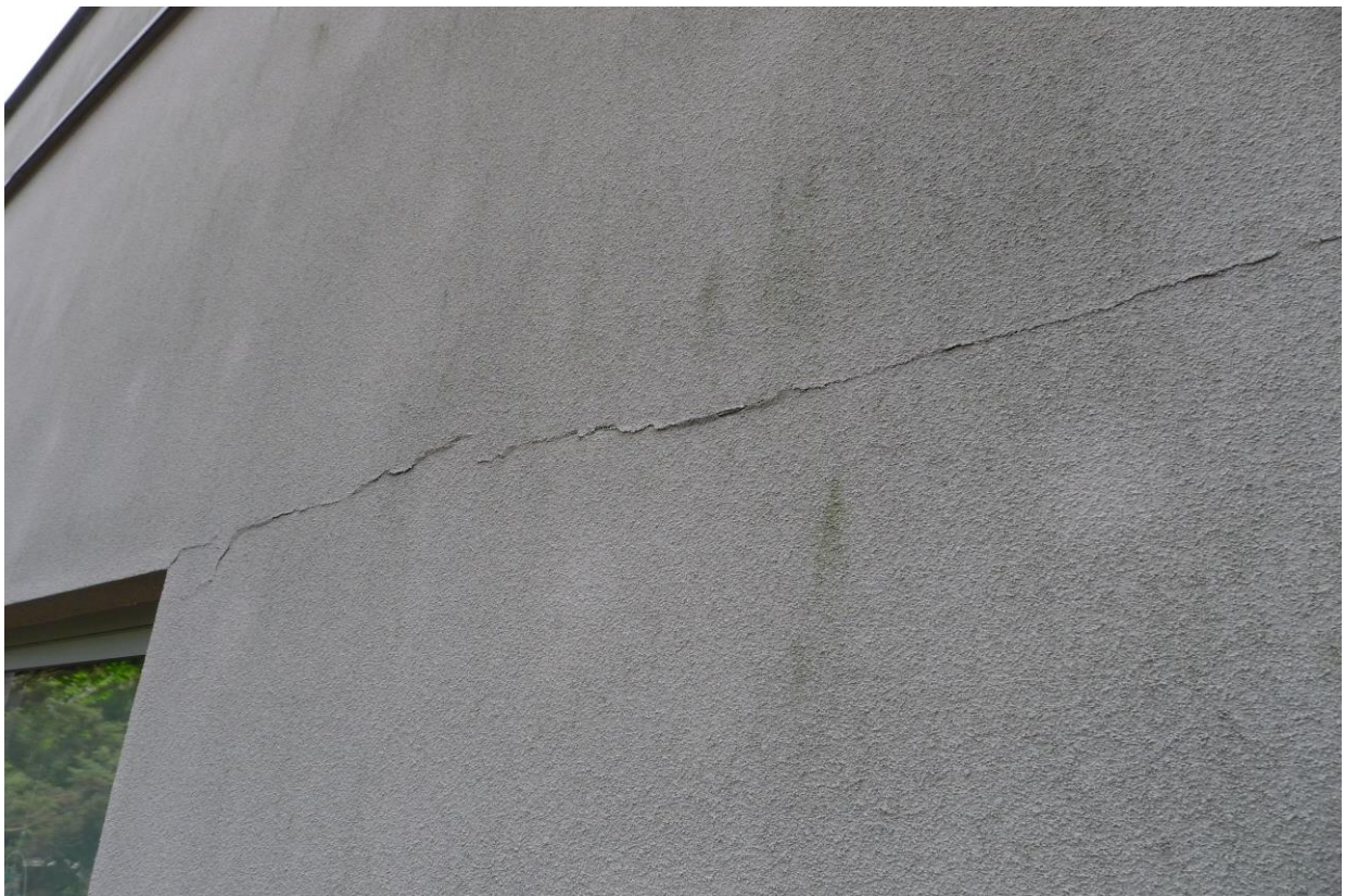
Rysy i spękania na tynku
